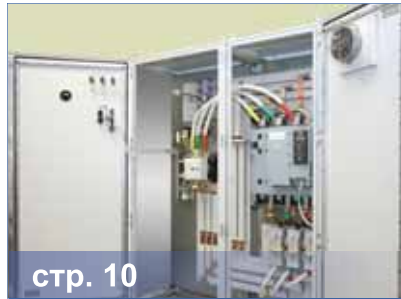
стр. 10 Модернизация оборудования для системы вентиляции на технологической линии по производству бутылочной стеклотары
